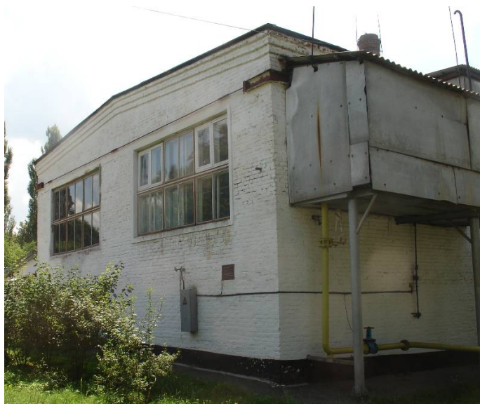
Рисунок 1 – Похилі тріщини у цегляних зовнішніх стінах
