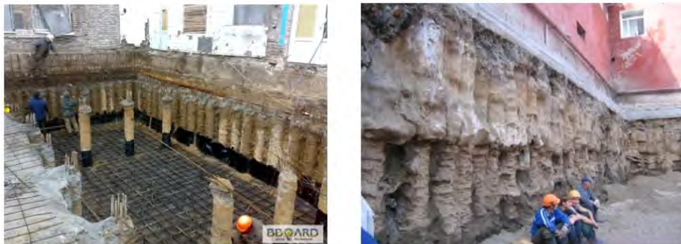
Рисунок 3 – Підсилення стрічкових фундаментів житлових будівель стрічкою ґрунтоцементних колон, що накладаються одна на одну, створюючи, так звану, антифільтраційну завісу.
