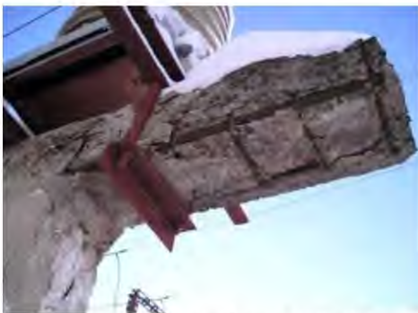
Рисунок 1 – Атмосферна корозія стояка лінії електропередач.
