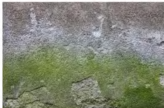
Рисунок 2 – Руйнування заглибленої в ґрунт бетонної поверхні.
